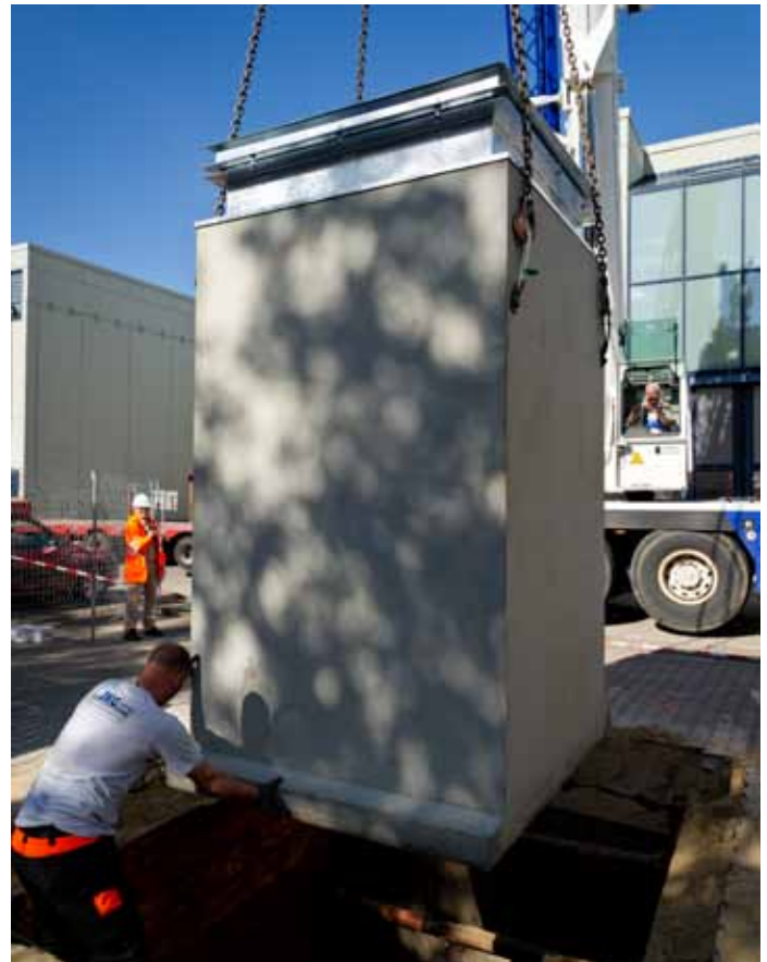
Ab unter die Erde: Die Unterflursysteme der BSR zur Abfallentsorgung. Foto: BSR
